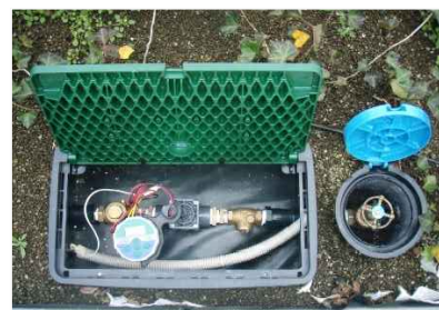
プロSコントローラー取付
